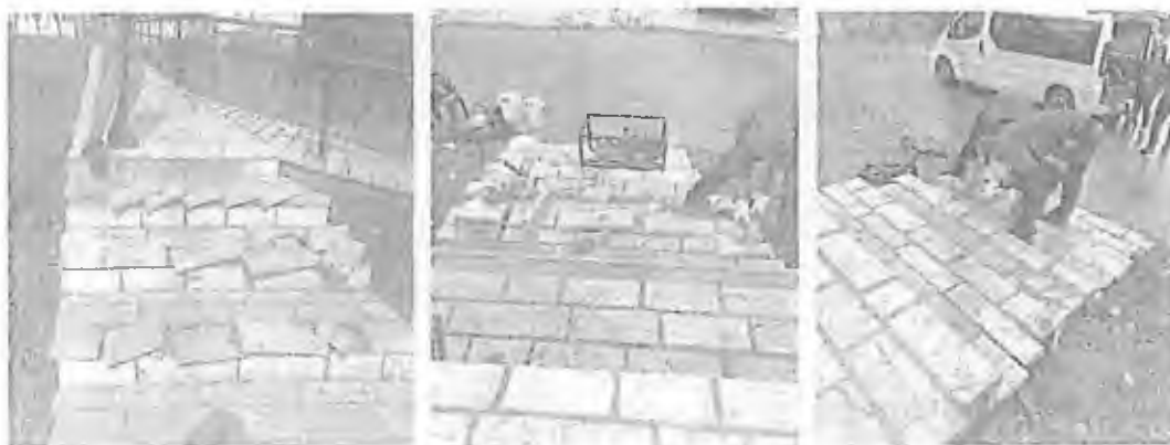
Sanacija stepeništa na mezru ŽIŠ od strane uposlenika Odsijeka za uređenje i održavanje mezarja i spomen obilježja u sklopu redvonih aktivnosti
